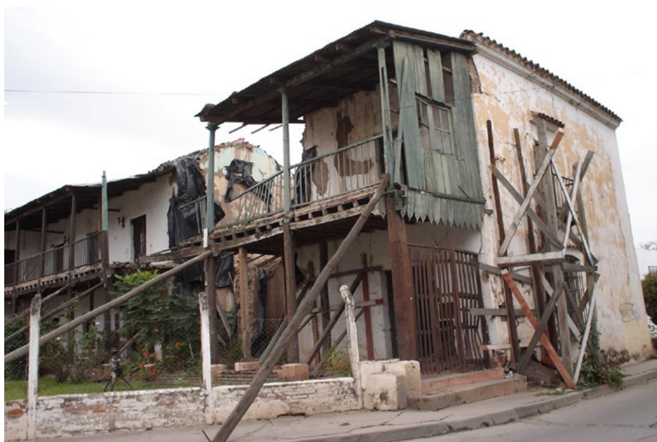
Figura 5. Casa-Hacienda con sector colapsado.
